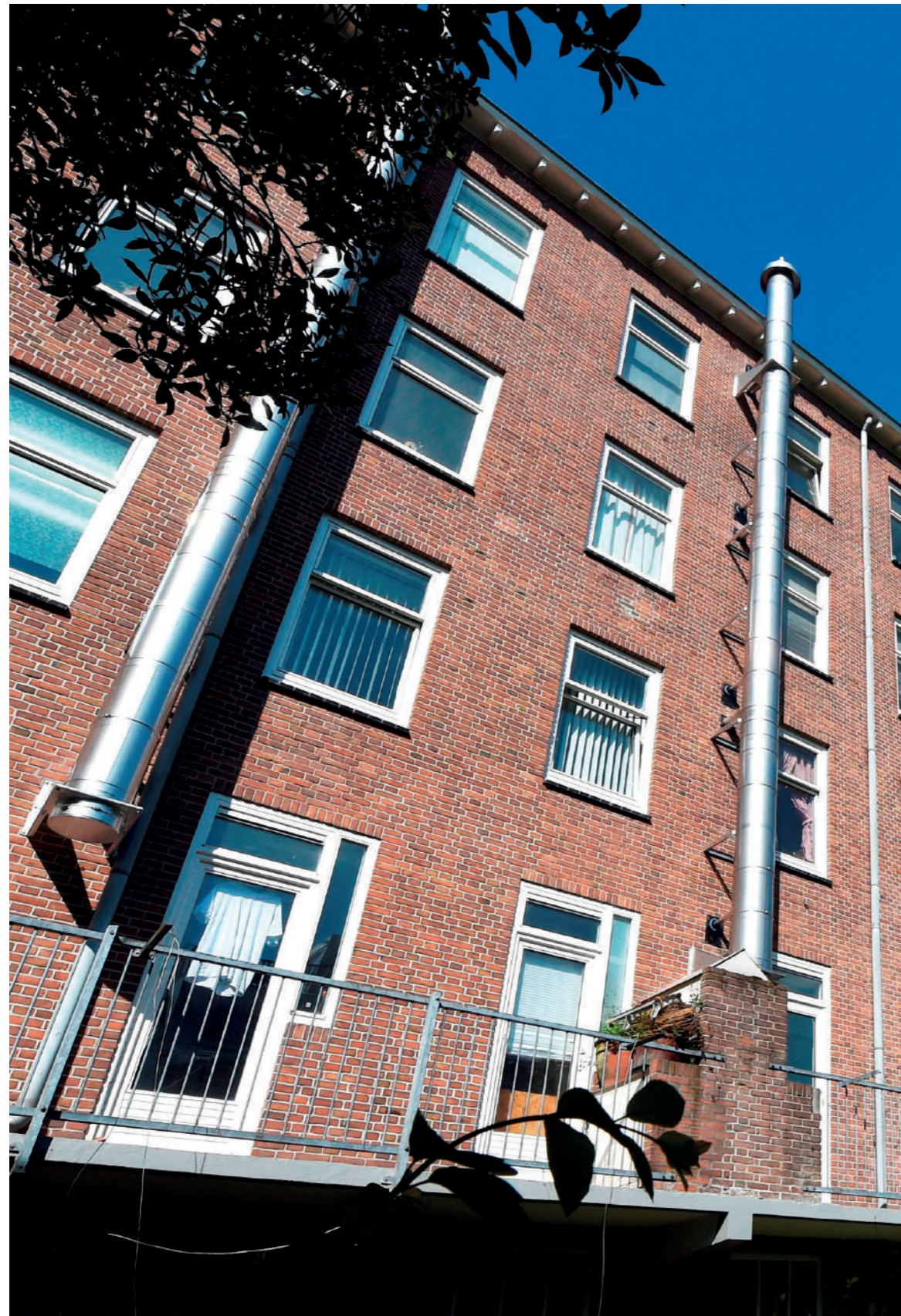
Collectief afvoersysteem dat tegen de buitengevel gemonteerd is
