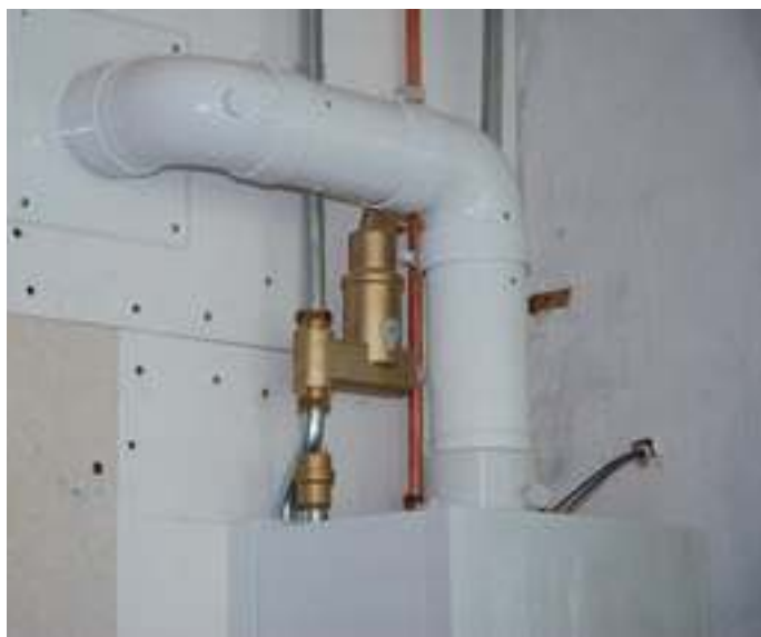
De concentrische aansluiting in de woning is de veiligste oplossing, omdat verbrandingsgassen nooit in de woning terecht kunnen komen.
